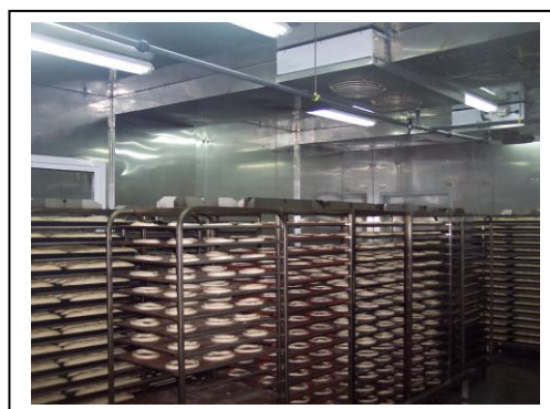
Interior de una cámara de 32 carros de 0,90 m x 0,60 m
