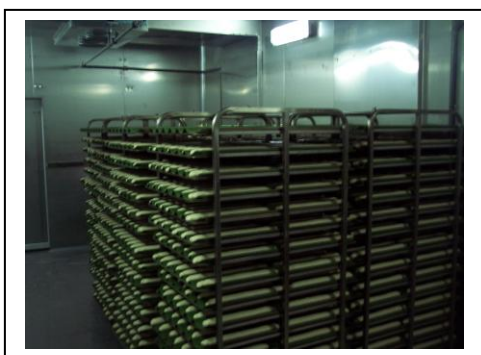
Interior de una cámara de 20 carros de 1,00 m x 0,80 m
