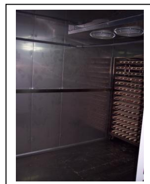
Interior de una cámara de 6 carros de 1,00 m x 0,80 m
