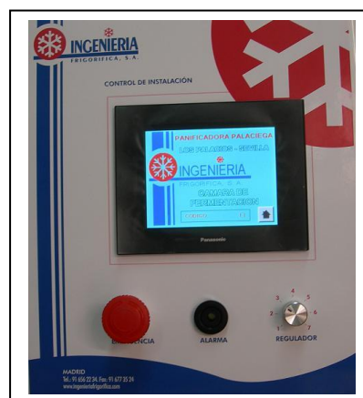
Cuadro de control
