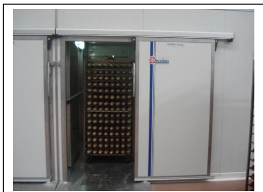
Cámara de 12 carros de 1,00 m x 0,80 m con puerta corredera
