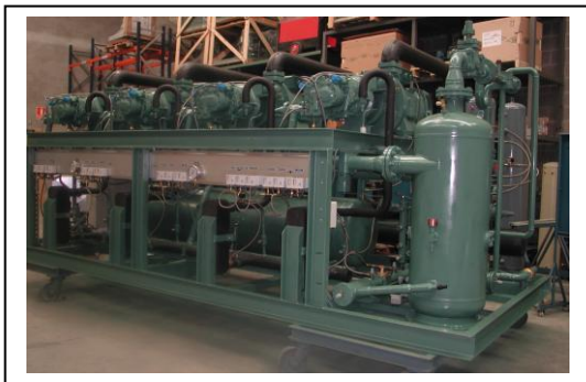
Central frigorífica de cuatro compresores de tornillo de 100 CV cada uno
