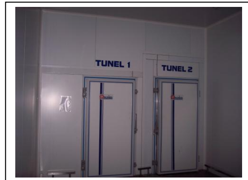
Entrada a dos túneles modelo TC-250
