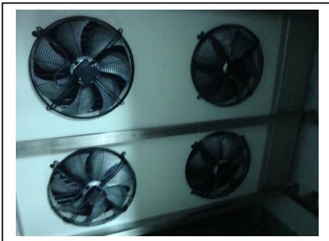
Evaporador de túnel TC-250 para quesadas pasiegas
